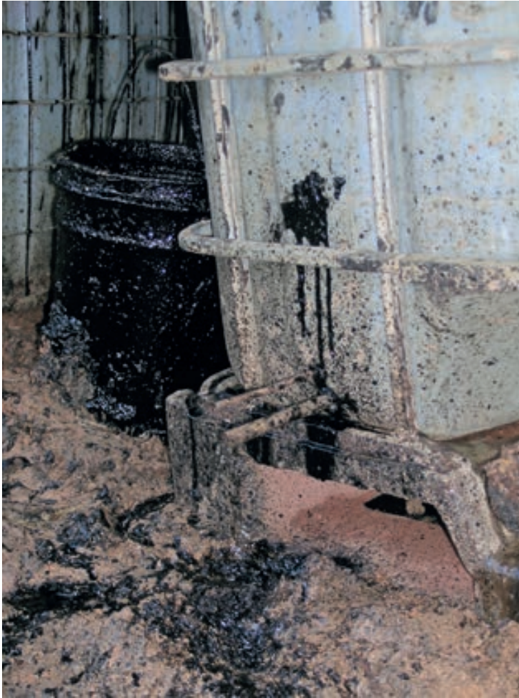
Tanques donde acumulan el crudo con fisuras que llegan al río Manchari. Fuente: Marti Orta-Martínez. FECONACO
