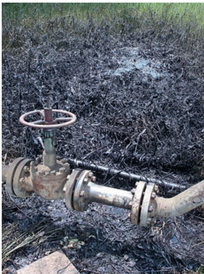
Derrame por mal estado de la válvula de un pozo. Bateria Forestal. Fuente: Martí Orta-Martínez. FECONACO
