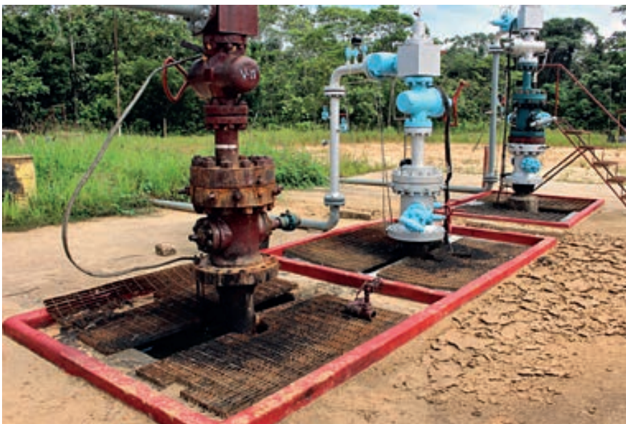
Pozo mal abandonado en la cuenca del Tigre. Fuente: PUINAMUDT.
